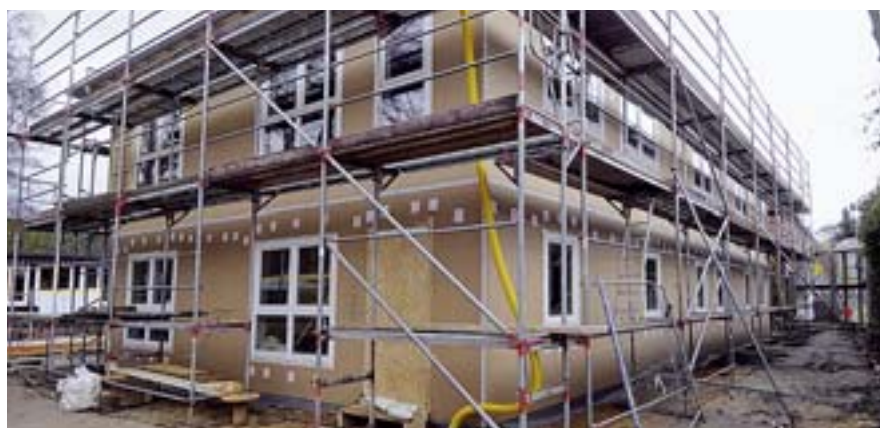
Auftraggeber überzeugt: Accoya-Fenster in der Kindertagesstätte in Hamburg
